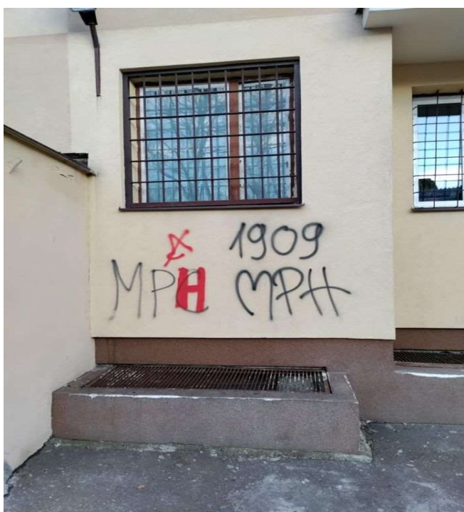
Zniszczone elewacje budynków na os. Kmiecie-Wieniawskiego
